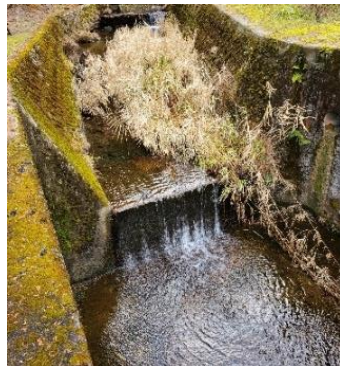
図:堰堤7の様子
